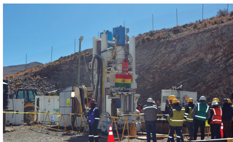
Perforadora para chimeneas de respiración, E.M. Huanuni.
