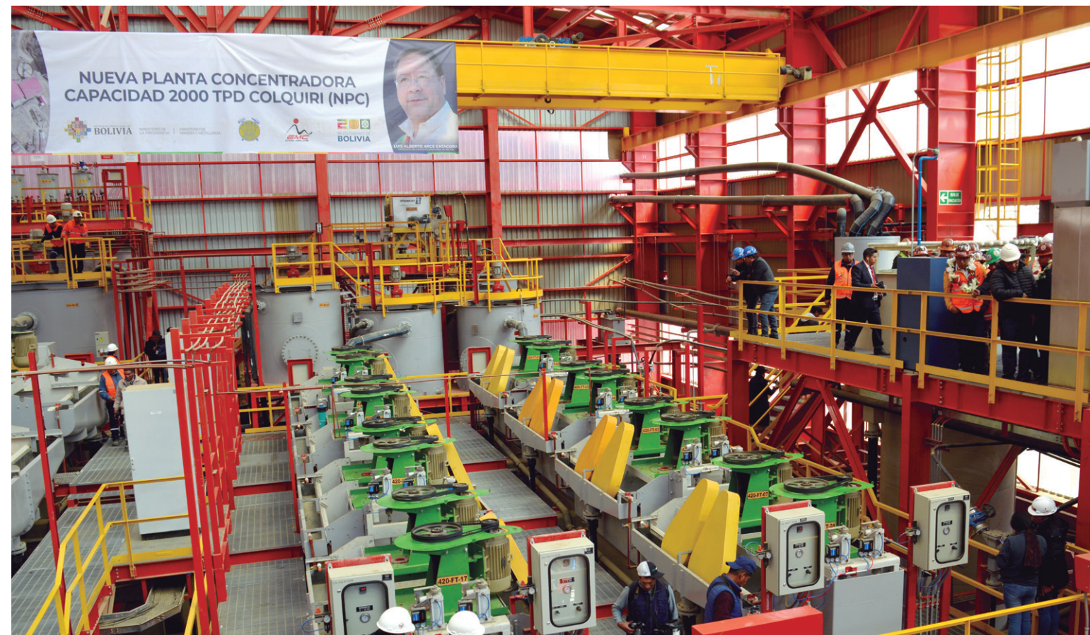
La imagen muestra el interior de la nueva Planta Procesadora de Estaño y Zinc en la Empresa Minera Colquiri.
