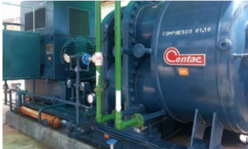
Compresor de la Planta de Oxígeno
